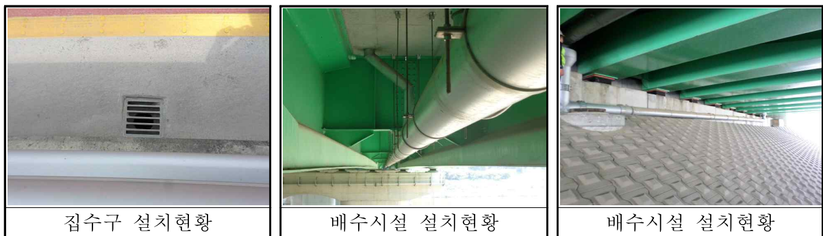
【그림 3.27】 배수시설 현황
