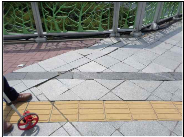
보도블럭 파손(화강석) (S6경간)
