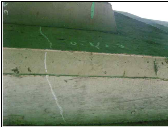
받침콘크리트 cw=0.3mm미만 균열(P1)
