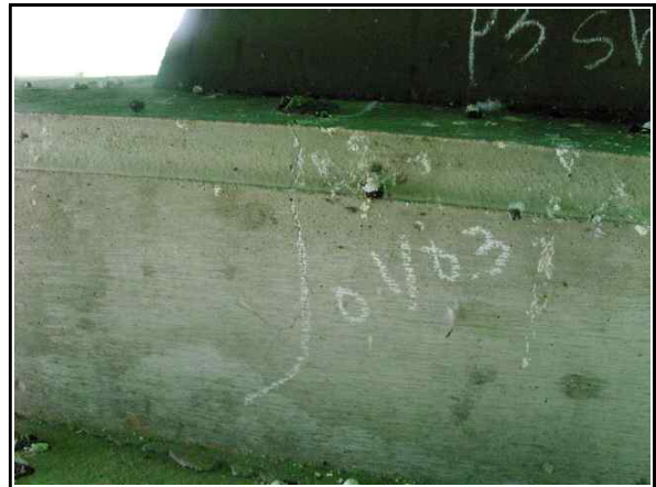
받침콘크리트 cw=0.3mm미만 균열(P3)
